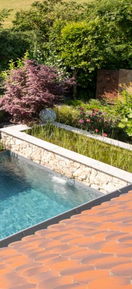
▲ Beim Strohschirm befindet sich der Pumpenschacht, der in zwei Kreisläufen das Wasser vom Skimmer unter dem Oberflurrolladen zur Filterzone führt, wo sich auch die Wasserlippe befindet (rechts am Bildrand).
